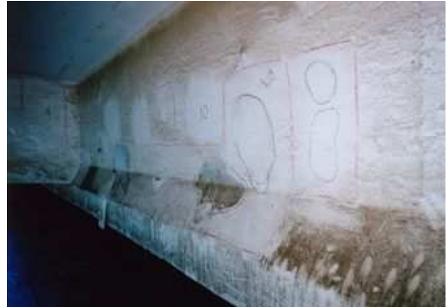
写真2 主桁劣化状況（浮き）
