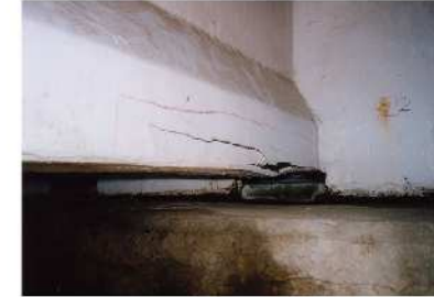
写真3 主桁劣化状況（ひび割れ・剥離）
