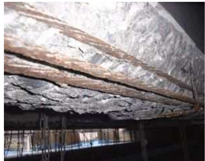
写真4 PC鋼材腐食状況
