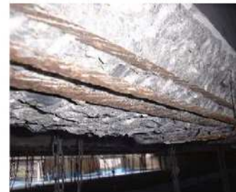
写真4 PC鋼材腐食状況
