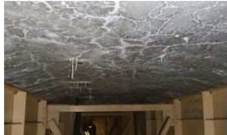
既設床版の損傷状況
