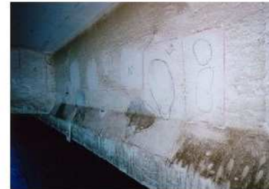
写真2 主桁劣化状況（浮き）
