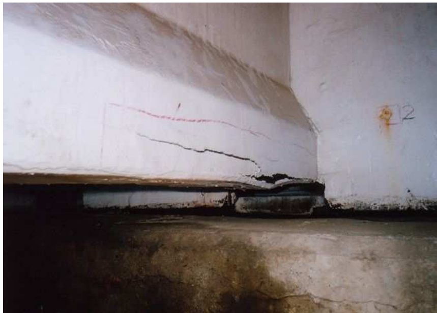
写真3 主桁劣化状況（ひび割れ・剥離）
