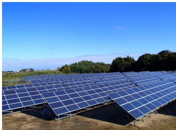
高千穂事業所：東伯郡大栄町高千穂（H20 完了） 太陽光発電所
